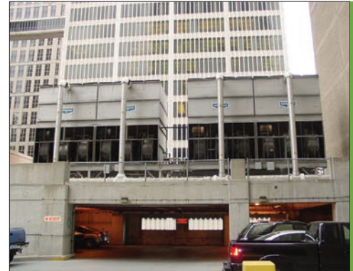
Centrifugal Fan Units
